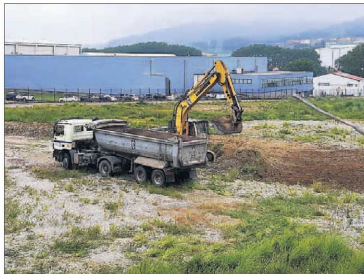
Comienzo de las obras del antiguo solar de la Schweppes, en Sabón. | L. O.
